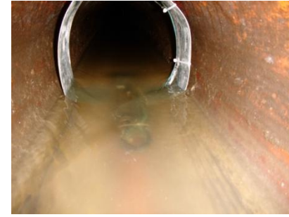
Caudalímetro instalado en el colector de margen del Regato de Comares
