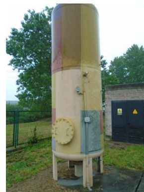
FOTO 46 (Instalaciones e equipos)
