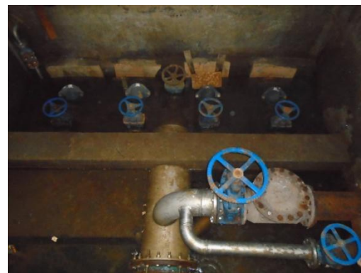
FOTO 45 (Instalaciones e equipos)
