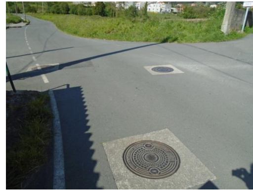
FOTO 14 (Trazado colector; red de saneamiento existente y cruce con red de abastecimiento)
