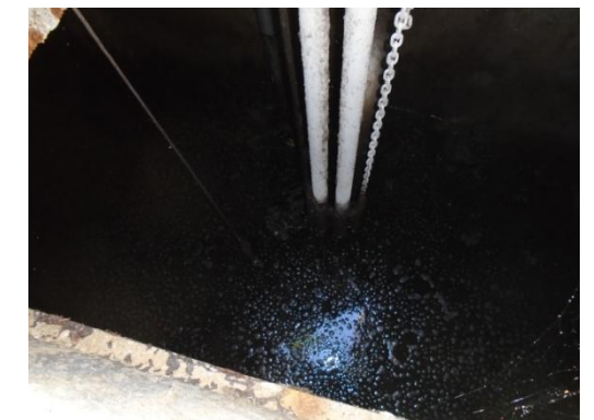
FOTO 36 (Cámara de retención y grupo de bombeo)
