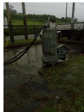
FOTO 48 Instalaciones e equipos)
