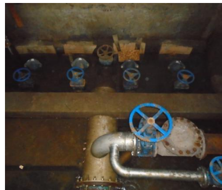
FOTO 45 (Instalaciones e equipos)
