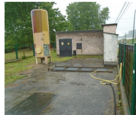
FOTO 47 (Instalaciones e equipos)
