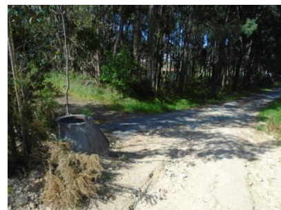
Pozo de conexión con el Polígono Ramal 2
