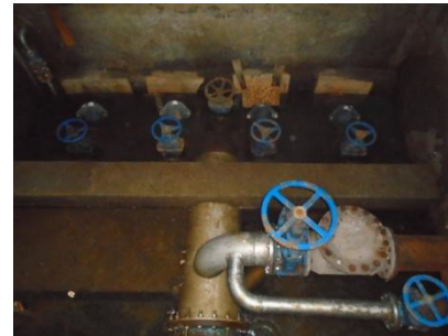
Imagen del interior de la EBAR
