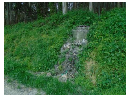
Vista del entorno de las tapas de registro con indicios evidentes de alivio
