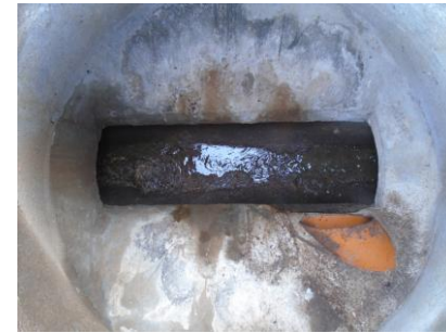
Red secundaria aguas arriba (la infiltración se localiza en los tramos intermedios)
