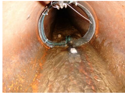
Caudalímetro instalado en el colector de margen del Regato de Morás (obsérvese la nitidez del agua)
