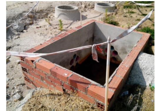
FOTO.- 17 / ARQUETA CT P.A.E. (TRANSF)
