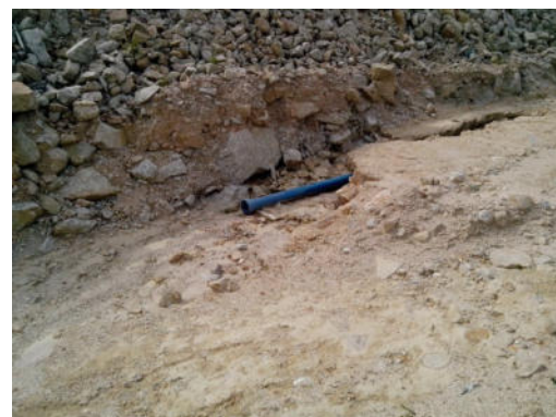
FOTO.- 13 / EL FINAL DE LOS TUBOS DESCONECTADOS DENTRO DE ZANJA.
