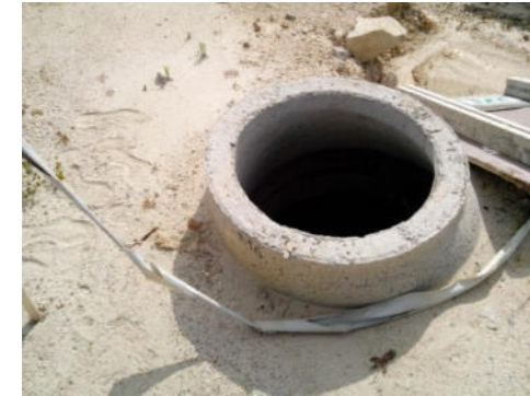
FOTO.- 2 / POZO DE PLUVIALES EN VIAL 1 CON CONO COLOCADO SIN CERCO.
