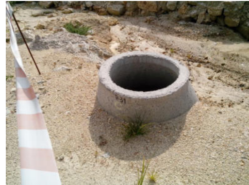
FOTO.- 10 / POZO DE RESIDUALES EN VIAL 3
