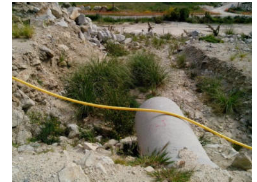
FOTO.- 5 / DESEMBOLCADURA DE COLECTOR DE VIAL 1 A ZONA DEL LAXOBRE.
