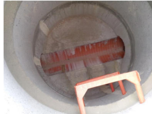
FOTO.- 11/ INTERIOR DE POZO DE RESIDUALES.
