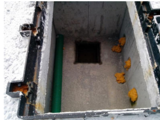
FOTO.- 32 / INTERIOR DE ARQUETA DE TIERRA DE C.E.
