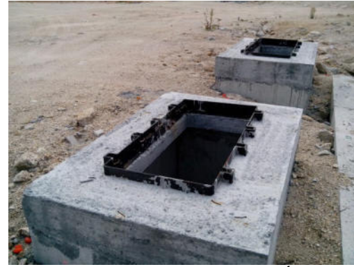
FOTO.- 31 / ARQUETA DE TOMA DE TIERRA DE CÁMARA DE EMPALMES.
