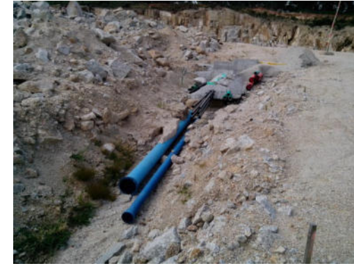
FOTO.- 14 / OTRO TRAMO DE TUBOS DESCONECTADOS EN ZANJA.
