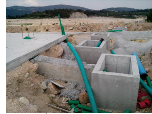
FOTO.- 24 / CONEXIÓN DE ARQUETAS 1C A SOLERA Y 2P DE FINAL DE TRAMO.
