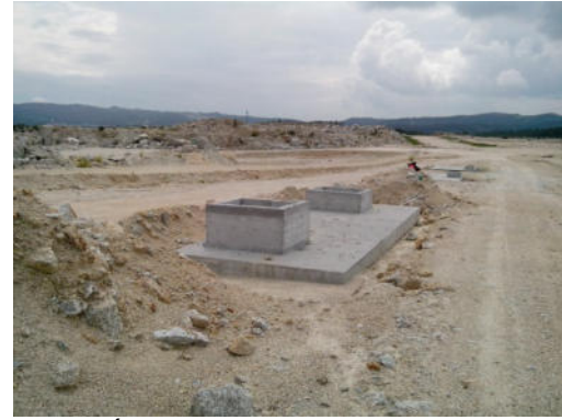
FOTO.- 30 / CÁMARA DE EMPALME CE-2
