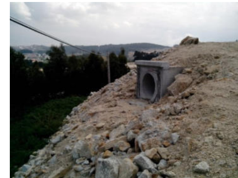
FOTO.- 6 / DESEMBOLCADURA DE COLECTOR DEL CAMINO DE SERVICIO DEL VIAL 3 SIN EJECUTAR LA RAMPA ESCALONADA.
