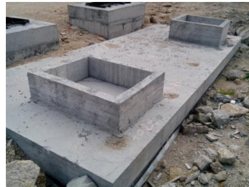
FOTO.- 33 / CÁMARA DE EMPALMES
