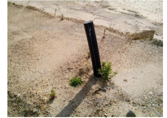
FOTO.- 15 / PUNTO DE HIDRANTE CON VÁSTAGO CONECTOR EN POLIPROPILENO SIN COLOCAR LA PIEZA SUPERIOR.
