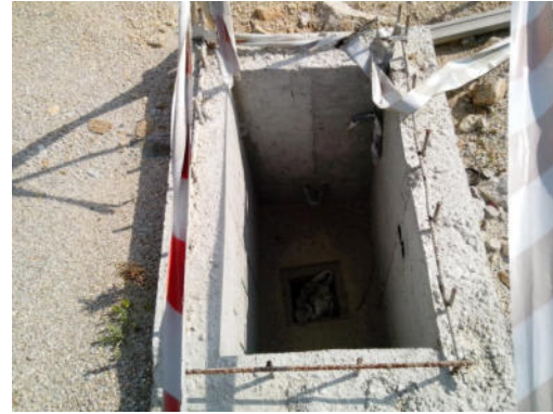
FOTO.- 20 / INTERIOR DE ARQUETA.
